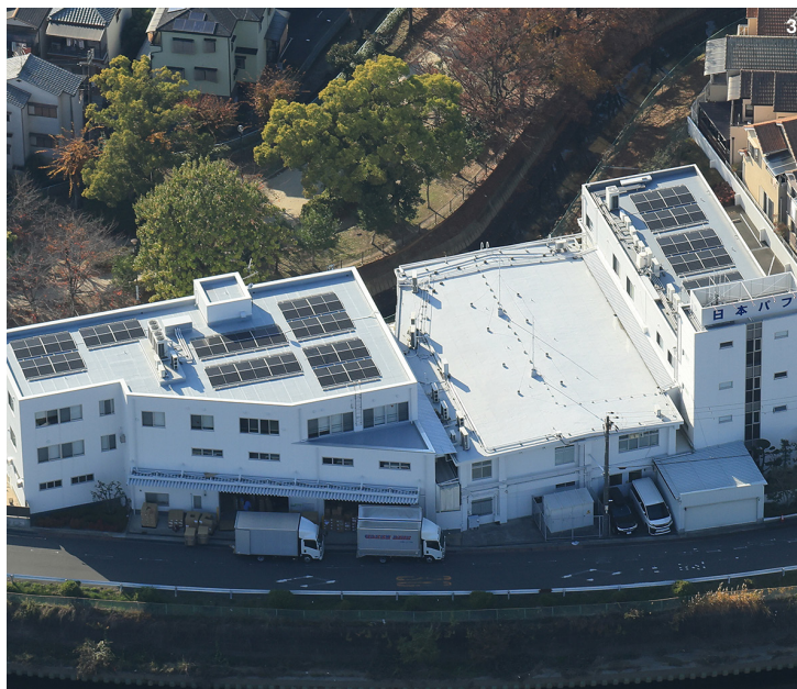
1 発電効率試算から割り出した適切な角度で設置した太陽光パネル。 2 発電した電力を社内で使用できるよう変換するパワーコンディショナー。 3 複数棟の屋上を活用した太陽光パネル。
